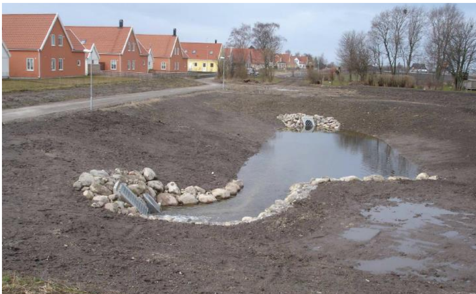
Bild 7. Fördröjningsdamm. Källa: www.vasyd.se .
