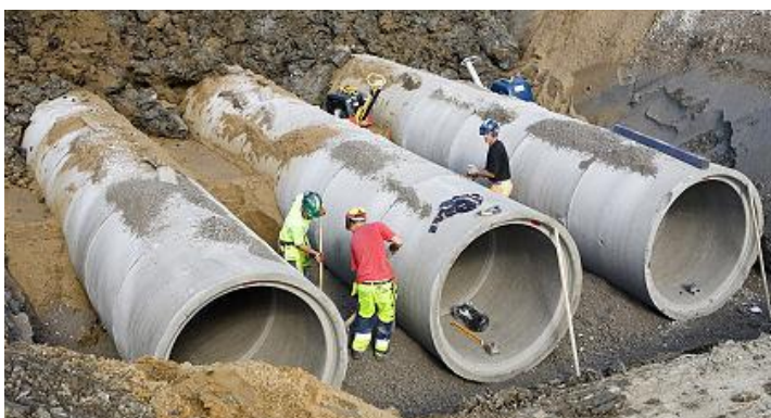
Bild 10. Dagvattenmagasin av betongrör Källa: www.steriks.se
